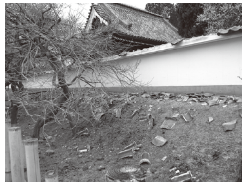
弘道館・孔子廟築地塀の瓦損傷・落下
