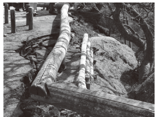
偕楽園・南崖(見晴広場)の法面崩れ
